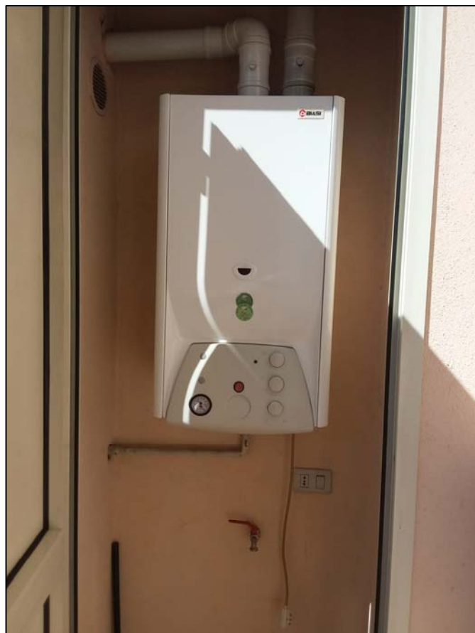
FOTO 32 - BALCONE CAMERA 4 - CALDAIA
