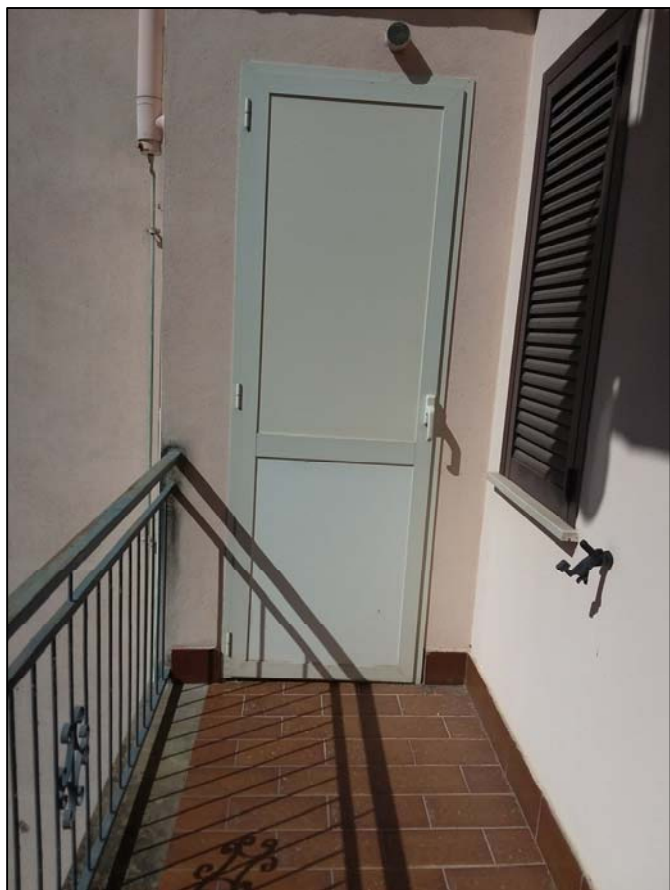
FOTO 31 - BALCONE CAMERA 4 - VANO TERMICO
